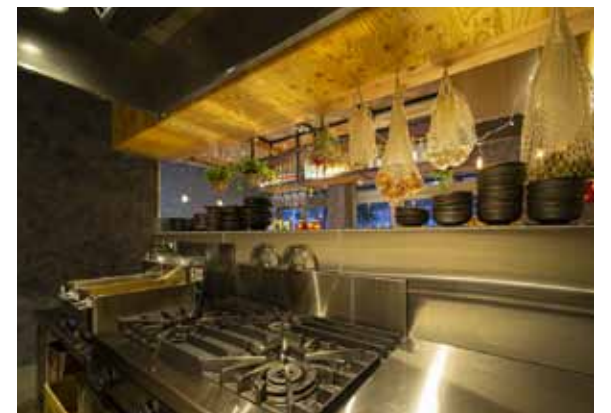
コンロやフライヤーなど調理器具が効率よく配置された奥のキッチン
